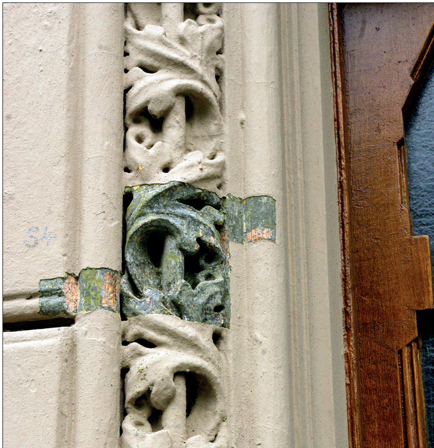
Obr. 38. Zaslepení detailů a ztráta plastičnosti štukových prvků opakovaným přetíráním fasády. (Praha, neogotická uliční fasáda domu č.p. 1669 ve Slezské ulici, prefabrikované štukové prvky s odhalenou původní barevností, 2013. Foto: Jiří Žioný)
