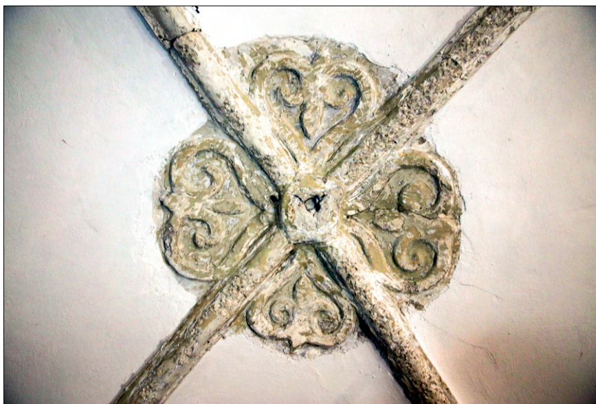
Obr. 42. Při necitlivém odstraňování druhotných vrstev špachtlí došlo k poškození vlastní hmoty štukového svorníku. (Zámek Hranice, detail klenby. Foto: Zdeněk Kovářik)
