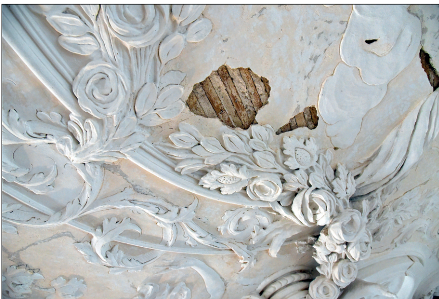
Obr. 26. Plasy, prelatura kláštera. Lokální ztráta adheze štukové vrstvy k podkladu představuje časté poškození štukové výzdoby stropů. V tomto případě je štuk nanesen přímo na laťování bez rákosu. Foto: Petr Kuneš.
