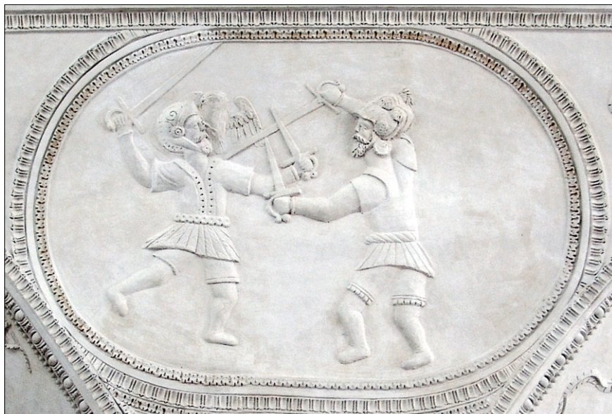
Obr. 40. Tvarově svévolná rekonstrukce štukového reliéfu, která nerespektuje grafickou předlohu, dle níž byla provedena původní renesanční kompozice. Místo napodobení původního složení byl reliéf navíc zhotoven v materiálově nevhodné sádře. (SZ Kratochvíle, Zlatý sál, doplněk pochází z restaurování v 50. letech 20. století, byl odstraněn během restaurátorských prací v letech 2006–2009 a nahrazen štukovým reliéfem vycházejícím z grafické předlohy Josta Ammana. Foto: Jana: Waisserová, 2005).
