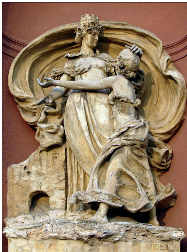
Obr. 29. Praha, pavilon lapidária Národního muzea na Výstavišti, štuková výzdoba z přestavby v roce 1908. Masioní rozpad exponovaných částí štukového reliéfu zhotoveného na bázi moderních hydraulických pojiv (hlinítanový cement). Foto: Petr Kuneš.
